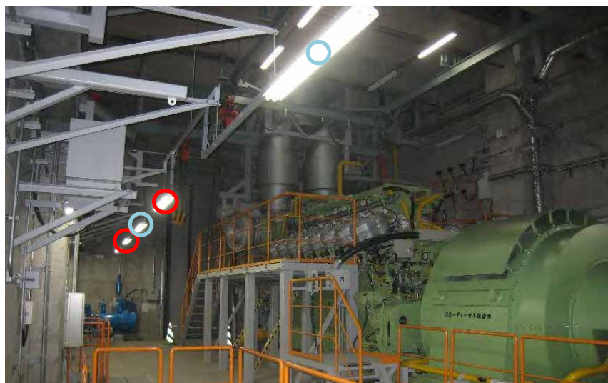
ディーゼル発電機建屋T. P. 10. 3m ディーゼル発電機室
