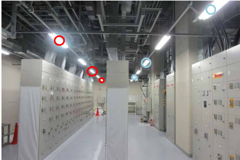
原子炉補助建屋T. P. 10. 3m 安全補機開閉器室
