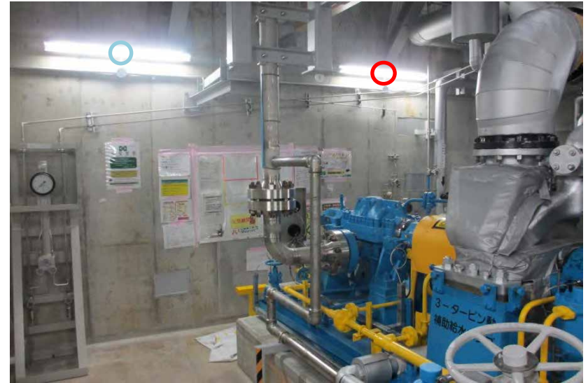
原子炉建屋T. P. 10. 3m タービン動補助給水ポンプ
