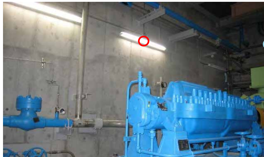
原子炉建屋T. P. 10. 3m 電動動補助給水ポンプ
