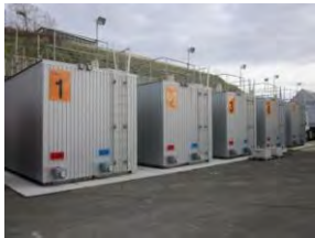
代替屋外給水タンク
