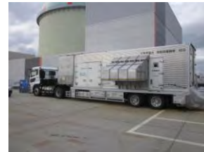
代替非常用発電機（3号用）
