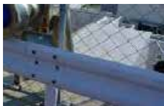
ガードレール
