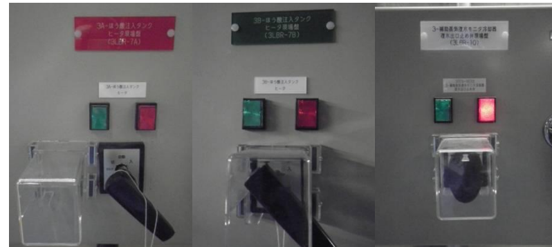
現場操作盤の識別 (スイッチカバー) (例)
