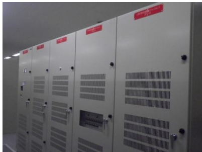
制御盤の識別(例)
