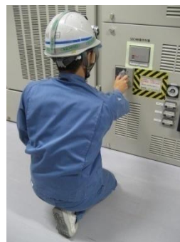
④440Vパワーコントロールセンタ 開放操作イメージ
