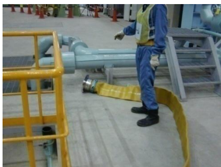
海水供給箇所フランジ部 (指差しているフランジを取外してホースを接続する。)
