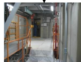
⑦R-D階段から主蒸気 管室へ
