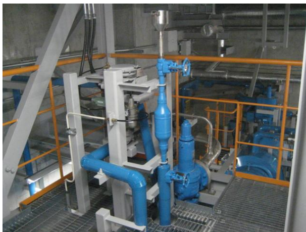
①原子炉補機冷却水サージタンク薬品添加口止め弁 (操作対象は2弁)
