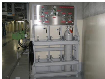
①窒素ガスポンベのイメージ 写真は、加压器逃がし弁用窒素ガスポンベ
