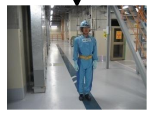
⑦ 燃料取替用水ポンプエリアから代替格納容器スプレイポンプ接続ライン
