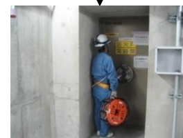
⑧主蒸気管室入口扉
