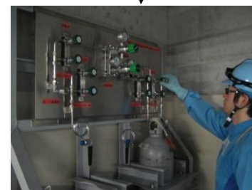
⑦窒素ガスポンベからの窒素供給操作 (バルブパネル操作) 写真は、加圧器逃がし弁用窒素ガスポンベ
