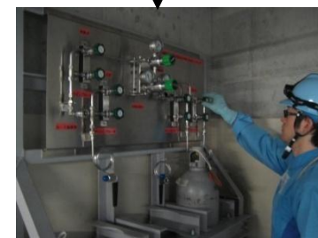
⑩窒素ガスボンベからの窒素供給 操作(バルブパネル操作)
