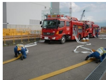
スクリーン室から循環水ポンプ建屋 入口へのホース延長・回収車 および作業員によるホースの 敷設・接続作業 (ホース敷設距離: 100m程度)
