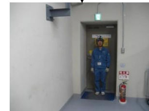
⑦安全補機開閉器室①
