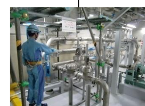
③6インチフレキシブル配管 5.5m 接続箇所 2箇所 (原子炉建屋T. P. 24. 8m)
