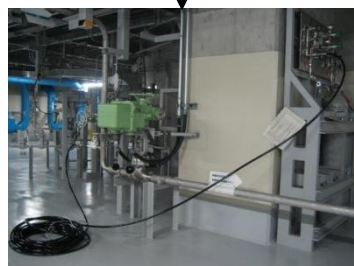
⑤窒素ガスポンベのホース接続イメージ 写真は、加圧器逃がし弁用窒素ガスポンベ
