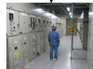
⑧安全補機開閉器室②
