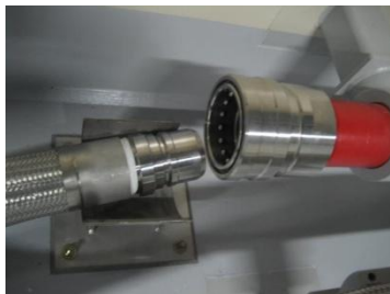
④出入口配管フレキシブル配管接続前イメージ 写真は、同様なフレキシブル配管(4インチ)を使用している格納容器スプレイラインと消火水ラインの接続部
