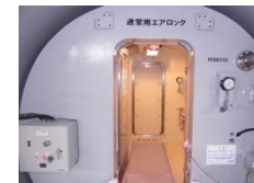
⑤格納容器通常エアロック 扉閉止確認 格納容器避難終了確認
