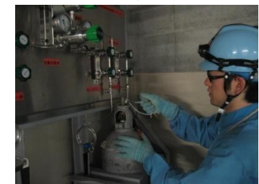
⑨窒素ガスボンベからの窒素供給 操作(ボンベ口金操作)
