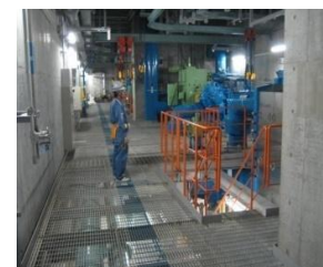
⑦原子炉補機冷却水ポンプエリア
