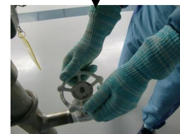
⑪窒素ガスボンベからの窒素供給 操作(系統側バルブ操作)
