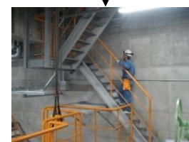
⑪主蒸気管室内、主蒸 気逃がし弁への移動③
