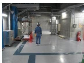
②6インチフレキシブル配管 10.0m 接続箇所 2箇所 (原子炉建屋T. P. 10. 3m)
