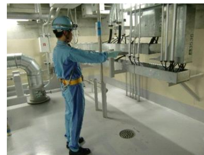
① 代替再循環ライン手動弁の「開」操作実施 (設置予定場所)
