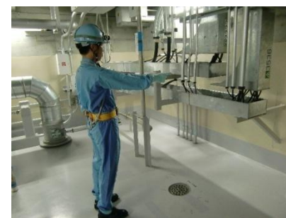
③RHRS-CSSタイライン弁の「開」操作実施 (設置予定場所)
