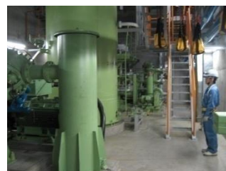
⑤制御用空気圧縮機室
