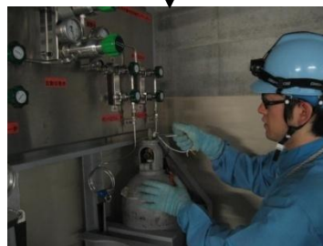
⑥窒素ガスポンベからの窒素供給操作 (ポンベ口金操作) 写真は、加圧器逃がし弁用窒素ガスポンベ
