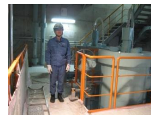
⑦原子炉補機冷却海水ポンプ室 出口ストレーナエリア
