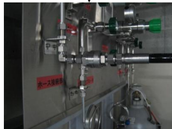
④窒素ガスポンベのカップラ接続後イメージ 写真は、加圧器逃がし弁用窒素ガスポンベ
