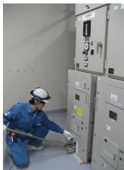
②6. 6kVメタクラ しゃ断器断路操作イメージ
