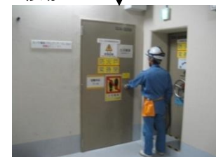
⑥安全補機開閉器室入口扉
