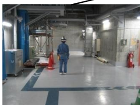
①2インチフレキシブル配管 6.5m × 2本 接続箇所 4箇所 (原子炉建屋T. P. 10. 3m)
