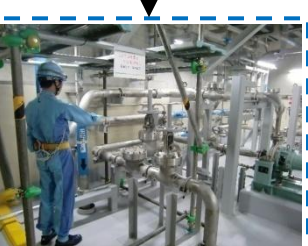
⑥ 燃料取替用水ポンプエリア (設置予定箇所)
