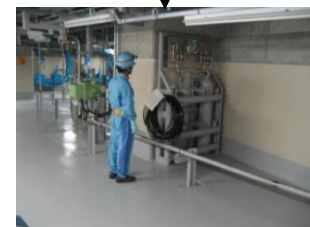
⑧加圧器逃がし弁操作用可搬 式窒素ガスボンベエリア
