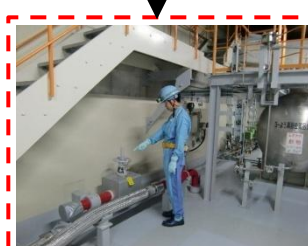
⑧ 代替格納容器スプレイポンプ接続ライン (設置予定箇所)
