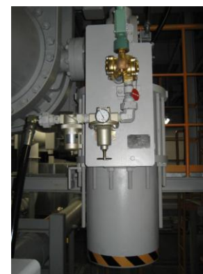
可搬型窒素ガスポンベにより 窒素供給されるダンパ
