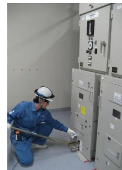
⑥6. 6kVメタクラ しゃ断器接続操作イメージ
