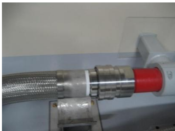
⑤出入口配管フレキシブル配管接続後イメージ 写真は、同様なフレキシブル配管(4インチ)を使用している格納容器スプレイラインと消火水ラインの接続部
