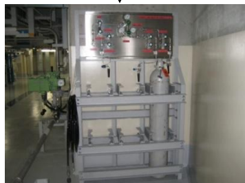
②窒素ガスポンベのイメージ 写真は、加圧器逃がし弁用窒素ガスポンベ
