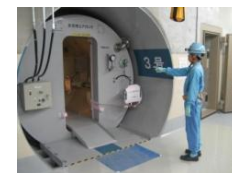
⑨格納容器非常用エ アロック扉閉止確認(写 真は外扉開放状態)
