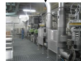
⑫主蒸気管室内、主蒸 気逃がし弁への移動④
