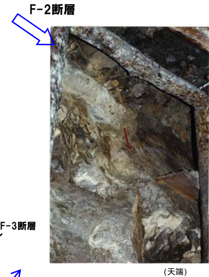
F-2断層露頭写真 (G坑) 始点からの距離115m
