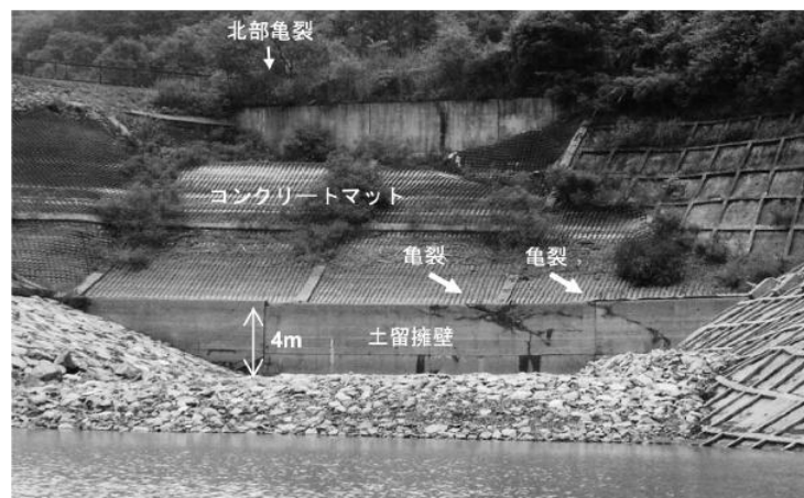
写真-2 土留擁壁への亀裂 右端のリップアップの盛り上がりは施工当時のもの.
