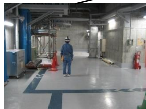
①2インチフレキシブルホース 6.5m×2本 接続箇所 4箇所 (原子炉建屋T. P. 10. 3m)
