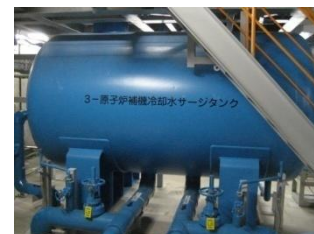
⑤原子炉補機冷却水サージタンクエリア
