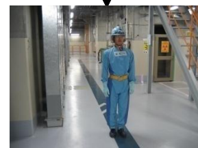
⑦ 燃料取替水ポンプエリアから代替格納容器スプレイポンプ接続ライン
