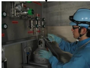
⑤窒素ガスボンベからの窒素供給操作 (ポンベロ金操作) 写真は、加圧器逃がし弁用窒素ガスボンベ
