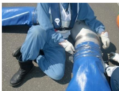
10m盤ホース接続部 (カップラティブではない)
