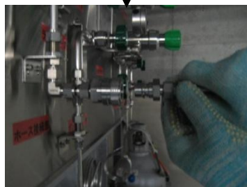
②窒素ガスボンベのカップラ接続前イメージ 写真は、加圧器逃がし弁用窒素ガスボンベ
