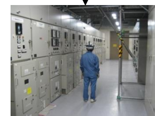
⑧安全補機開閉器室②
