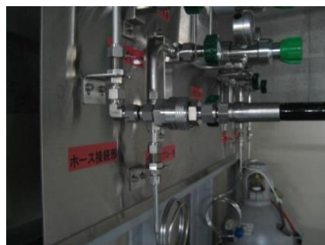
③窒素ガスポンベのカップラ接続後イメージ 写真は、加圧器逃がし弁用窒素ガスポンベ
