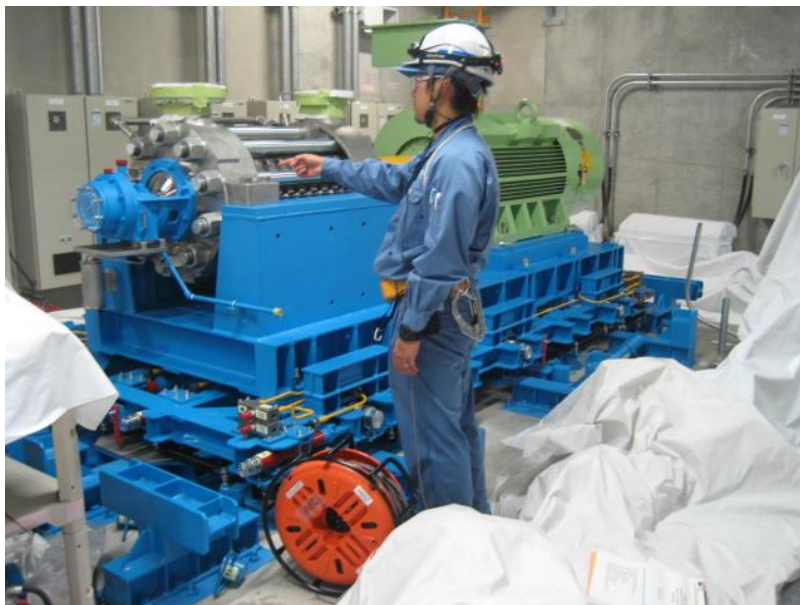
①代替格納容器スプレイポンプのイメージ 写真は、代替格納容器スプレイポンプと同様に 免震架台に設置されているSG直接給水ポンプ
