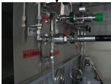
③窒素ガスボンベのカップラ接続後イメージ 写真は、加圧器逃がし弁用窒素ガスボンベ
