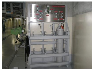
①窒素ガスポンベのイメージ 写真は、加圧器逃がし弁用窒素ガスポンベ
