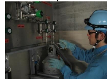
⑤窒素ガスポンベからの窒素供給操作 (ポンベ口金操作) 写真は、加圧器逃がし弁用窒素ガスポンベ
