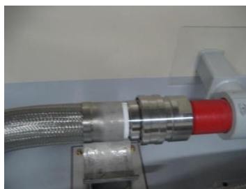
⑤出入口配管フレキシブルホース接続後イメージ 写真は、同様なフレキシブルホース(4インチ)を使用している格納容器スプレイラインと消火水ラインの接続部
