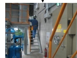
⑨主蒸気管室内、主蒸 気逃がし弁への移動①
