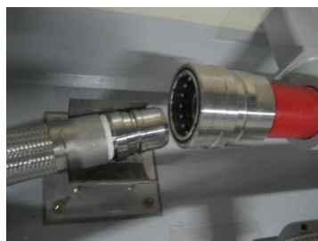
④出入口配管フレキシブルホース接続前イメージ 写真は、同様なフレキシブルホース(4インチ)を使用している格納容器スプレイラインと消火水ラインの接続部
