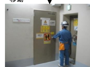
⑥安全補機開閉器室入口扉
