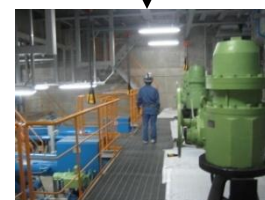
⑩主蒸気管室内、主蒸 気逃がし弁への移動②
