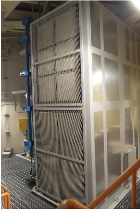
格納容器再循環ユニット
