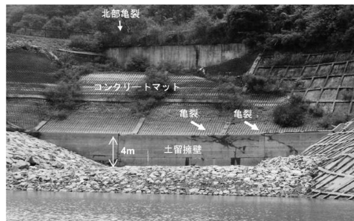
写真-2 土留擁壁への亀裂 右端のリップアップの盛り上がりは施工当時のもの.
