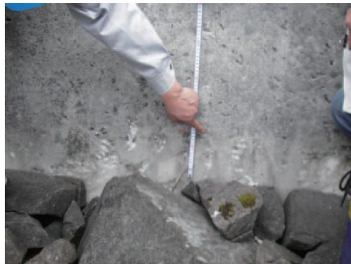
写真-5.23 リップラップと洪水吐き導流壁との隣接部のロック部の沈下痕跡
