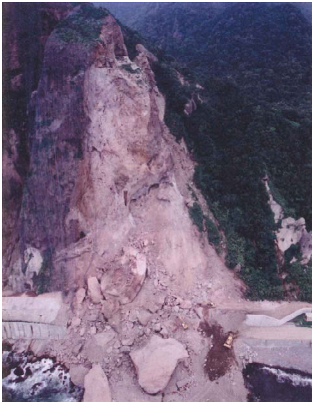
第2白糸トンネル第2回崩壊箇所全景 北海道地すべり学会 (2012) より
