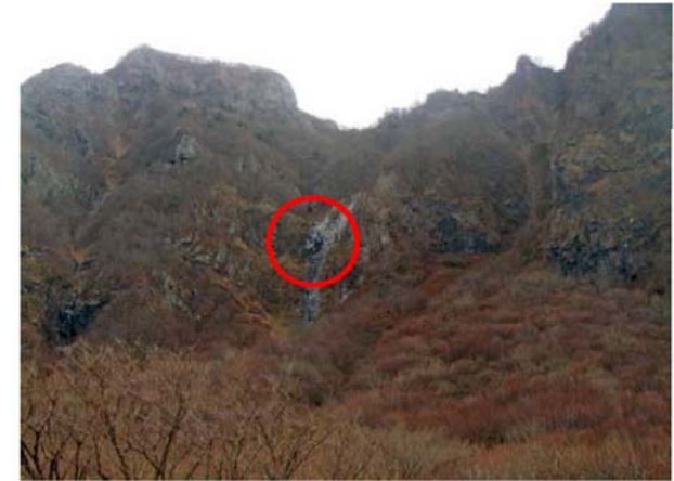
写真2: 雲間の滝付近の急崖 柱状節理の発達した堅硬な溶岩が露岩し、滑落崖等の地すべりを示唆する状況は認められない。
