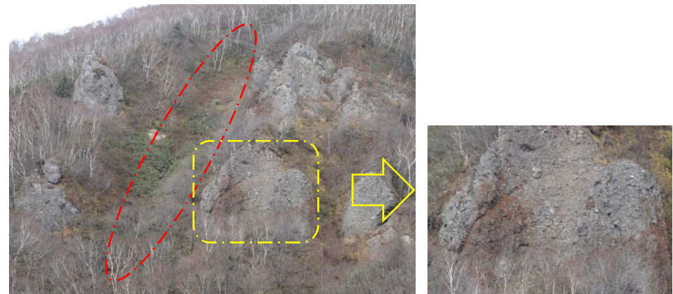
写真4: (写真3の拡大) 自破碎状溶岩の露頭は、凹凸に富み、肌落ちやブロックの抜けが認められる。露頭間は開析された沢地形を呈する。
