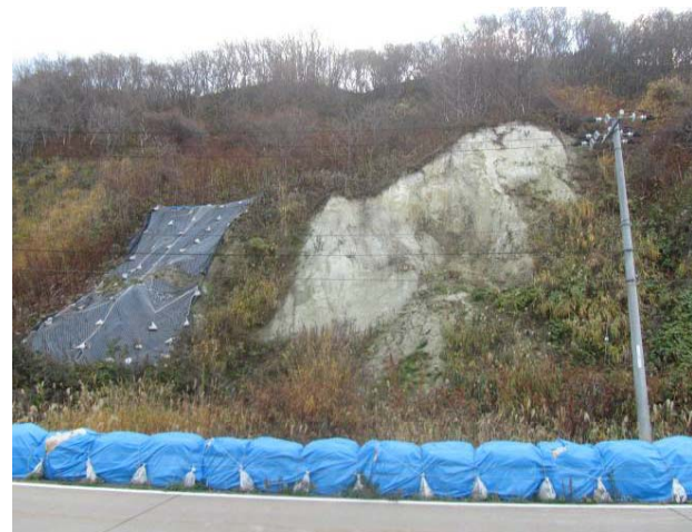
C05:ブロック7末端の崩壊地形 (古平層の凝灰岩)。
