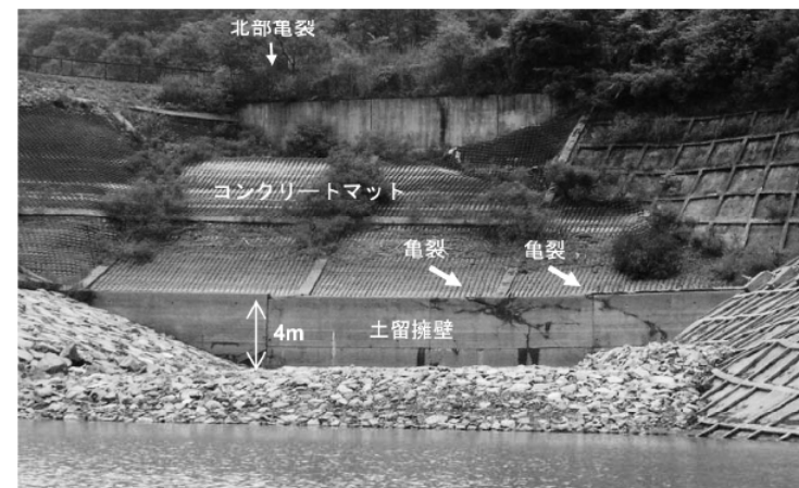
写真-2 土留擁壁への亀裂 右端のリップラップの盛り上がりは施工当時のもの.
