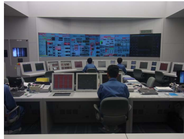
3号機中央制御室
