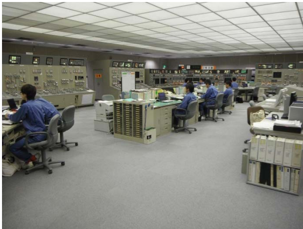
1, 2号機中央制御室
