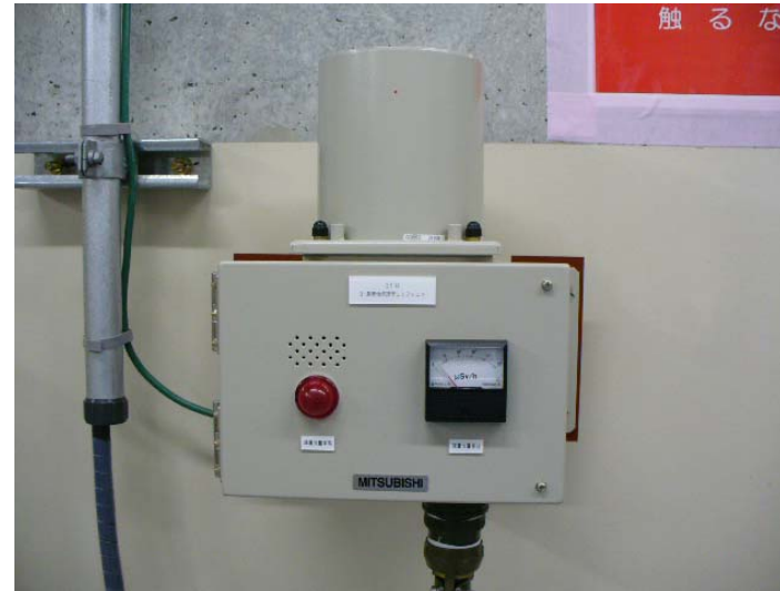
エリアモニタリング設備(エリアモニタ)
