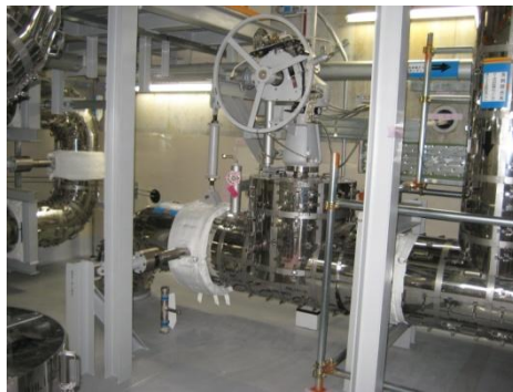
①余熱除去ポンプ入口弁 (原子炉補助建屋 T.P. 2.8m)
