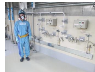
⑤ツインパワー弁操作場所
