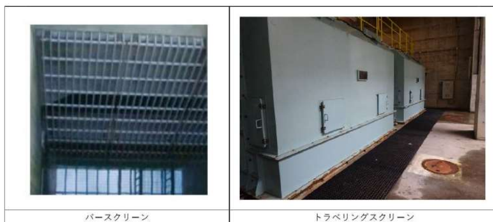
第 2.5-40 図 除塵設備写真
