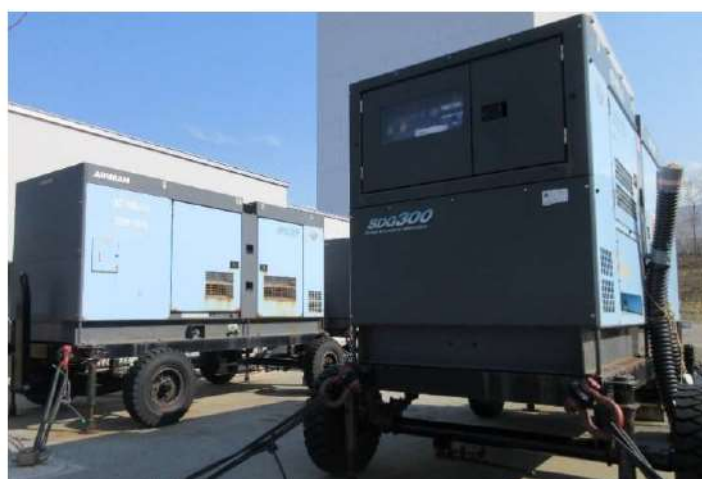
図4-11 緊急時対策所用発電機 外観
