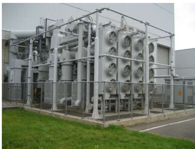
第1図 変圧器外観
