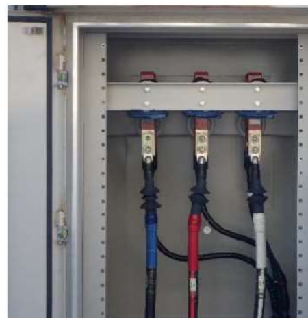
ボルト・ネジ接続 (代替交流電源)
