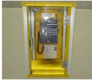
運転指令設備（警報装置を含む）
