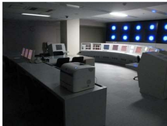
無停電運転保安灯点灯時
