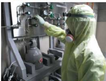
窒素供給操作(バルブパネル操作) (周辺補機棟 T.P. 40.3m)
