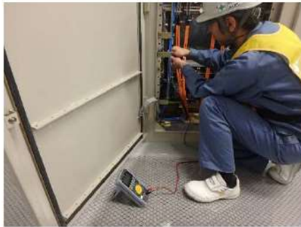
可搬型計測器接続
