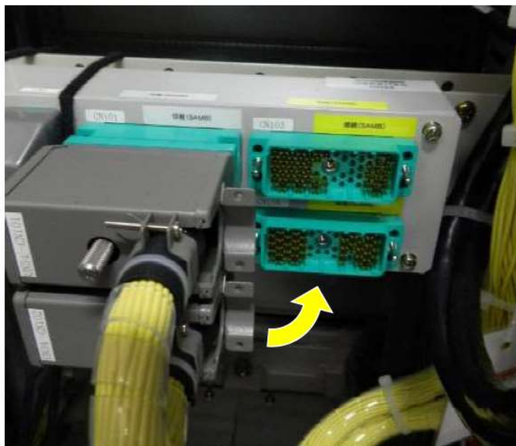
(1次系制御監視盤内 切替器)
