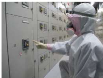
ディーゼル発電機燃料油移送ポンプ 受電準備 (安全補機開閉器室) (原子炉補助建屋T. P. 10. 3m)
