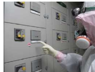
ディーゼル発電機燃料油移送ポンプ 起動操作 (ディーゼル発電機制御盤室) (周辺補機棟T. P. 10. 3m)
