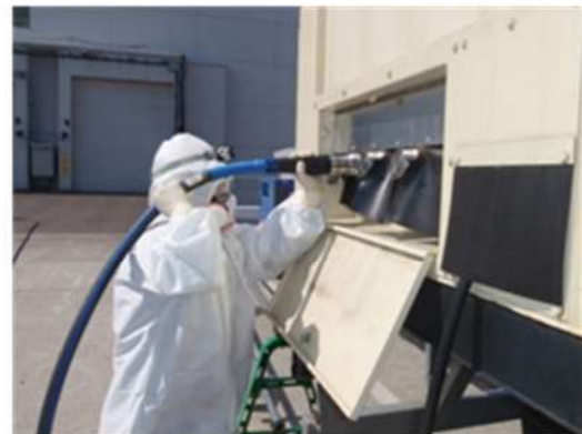
高圧ケーブル接続 (コネクタ) (屋外)
