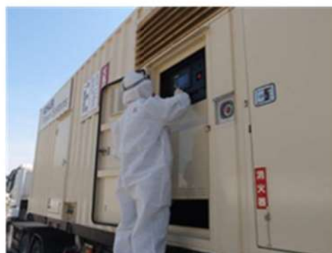
可搬型代替電源車起動 (屋外)
