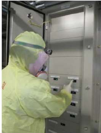
代替所内電気設備対象負荷の 切替・給電操作 (安全補機開閉器室) (原子炉補助建屋T.P. 10. 3m)
