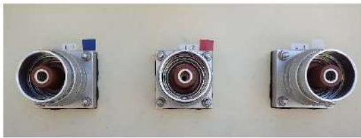
可搬型代替電源車高圧ケーブル接続箇所 (コネクタ) (屋外)
