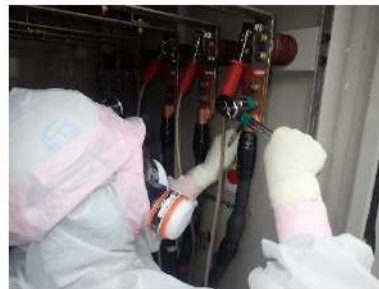
号炉間連絡ケーブル接続（端子） （屋外）
