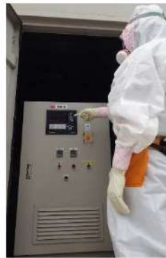
代替非常用発電機起動 (屋外)
