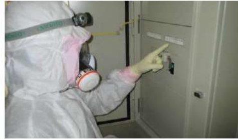
代替所内電気設備対象負荷の 切替・給電操作 (原子炉補助建屋T.P. 17. 8m)
