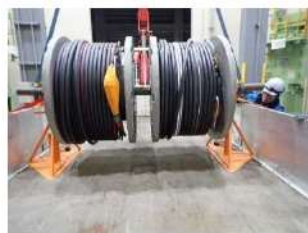
号炉間連絡予備ケーブル
