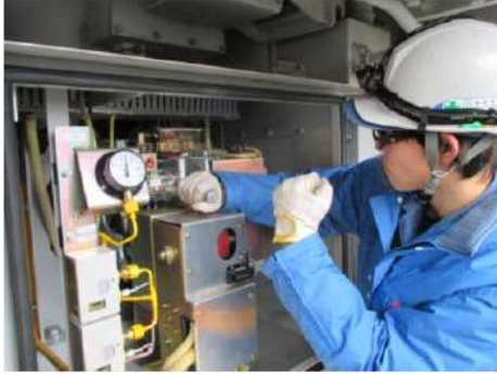
開閉所設備遮断器操作 (屋外)
