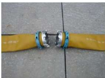
可搬型ホース（150A）接続前
