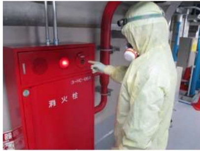
消火ポンプ起動 (周辺補機棟 T. P. 40. 3m)
