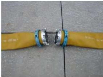
可搬型ホース（150A）接続前
