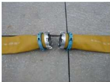
可搬型ホース（150A）接続前
