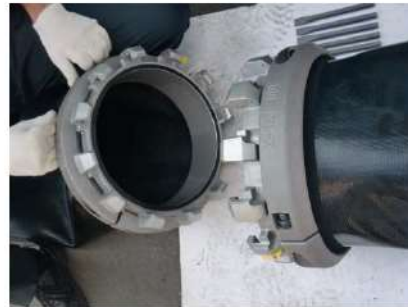
可搬型ホース(300A)接続
