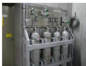
原子炉補機冷却水サージタンク 加圧用可搬型窒素ガスボンベ (周辺補機棟 T. P. 43. 6m)
