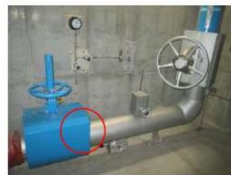
可搬型温度計測装置（格納容器再循環ユニット入口温度／出口温度）設置場所（排水側） (周辺補機棟 T. P. 17.8m)
