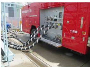
可搬型大型送水ポンプ車の設置 ポンプ車周辺のホース敷設 (屋外)
