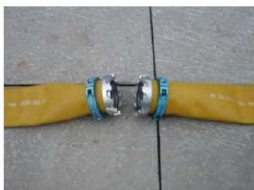
可搬型ホース(150A)接続前
