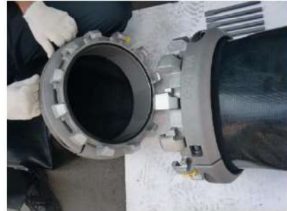
可搬型ホース(300A)接続
