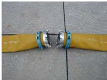
可搬型ホース(150A)接続前
