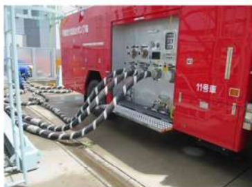
可搬型大型送水ポンプ車の設置 ポンプ車周辺のホース敷設 (屋外)
