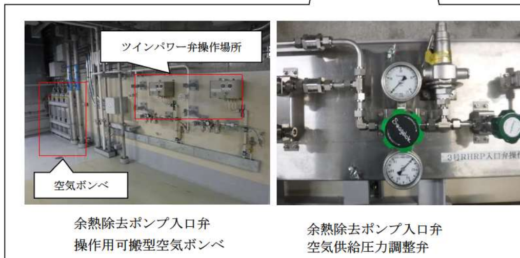
図3 ツインパワー弁操作場所及び余熱除去ポンプ入口弁操作作用可搬型空気ポンベ
