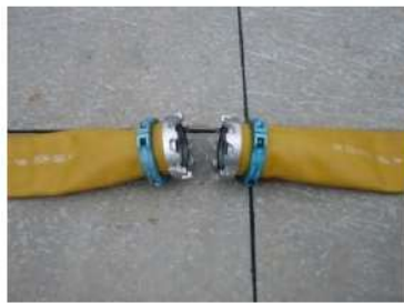
可搬型ホース（150A）接続前
