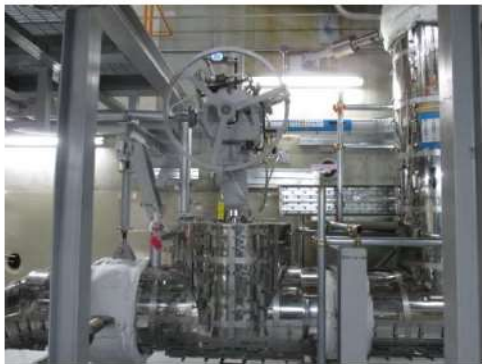
3 A - 余熱除去ポンプ入口弁 (3V-RH-005A)
