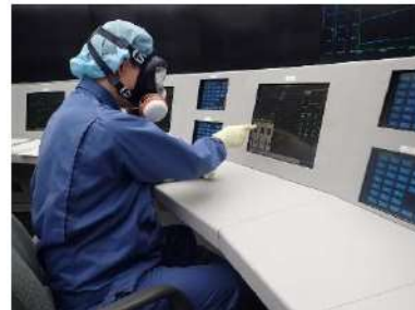
主蒸気逃がし弁開操作 （中央制御室）
