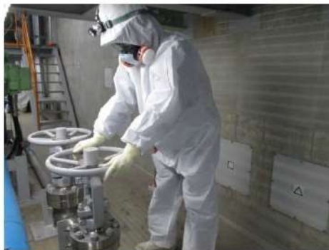
可搬型大型送水ポンプ車による 蒸気発生器への注水系統構成 (周辺補機棟 T.P. 29. 3m)
