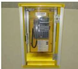
運転指令設備（警報装置を含む）
