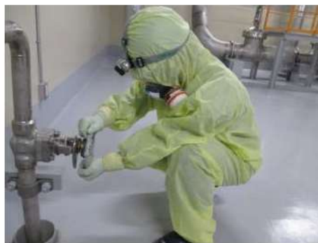
燃料取替用水ピット 補給ライン系統構成 (原子炉建屋 T.P. 17.8m)
