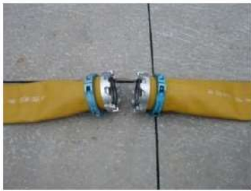
可搬型ホース（150A）接続前
