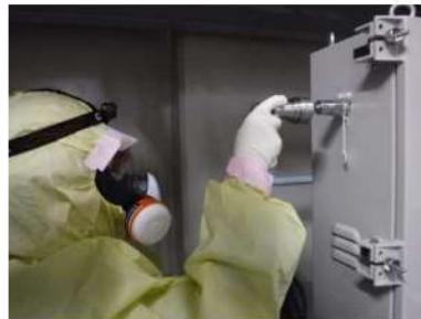
可搬型アニュラス水素濃度計測ユニットの接続 (原子炉建屋 T. P. 24. 8m)
