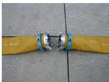
可搬型ホース(150A)接続前
