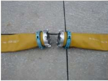
可搬型ホース（150A）接続前
