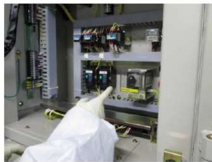
受電遮断器操作 (原子炉補助建屋 T.P.10.3m)
