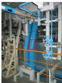
可搬型温度計測装置（格納容器再循環ユニット入口温度／出口温度）設置場所（供給側） （原子炉建屋 T. P. 14.3m）
