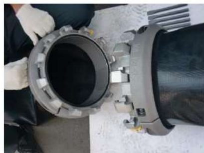
可搬型ホース(300A)接続
