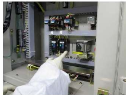
受電遮断器操作 (原子炉補助建屋 T. P. 10. 3m)
