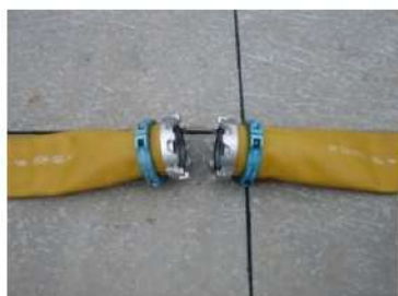
可搬型ホース（150A）接続前
