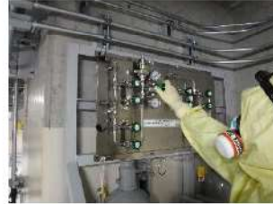
加圧器逃がし弁操作用 可搬型窒素ガスボンベ 供給操作 (原子炉建屋 T.P. 17.8m)
