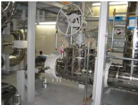
余熱除去ポンプ入口弁 (原子炉補助建屋 T. P. 2. 8m)
