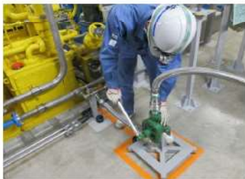
潤滑油供給操作 （原子炉建屋 T. P. 10. 3m）
