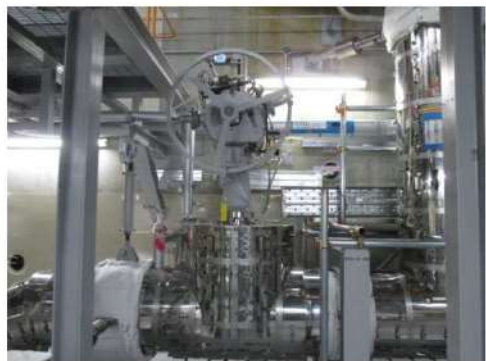
3 A-余熱除去ポンプ入口弁 (3V-RH-005A)
