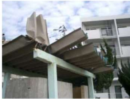
屋外トイレ屋根の損傷
