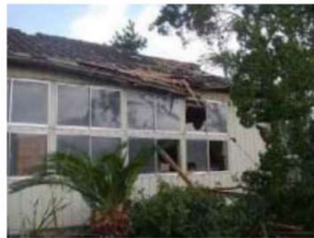
倉庫の窓ガラスと屋根の被害状況
