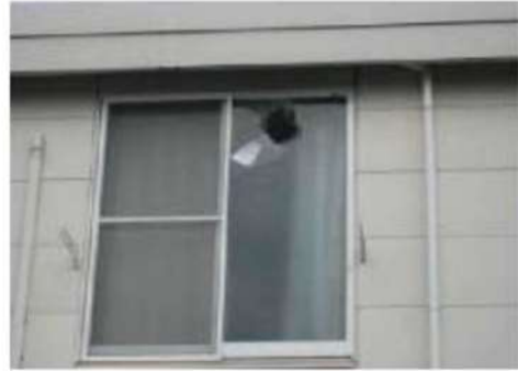
窓ガラスの飛来物衝突痕
