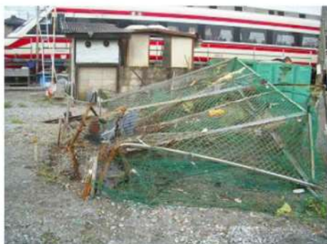
フェンスの著しい変形
