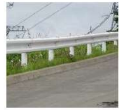
ガードレール
