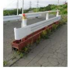
ガードレール
