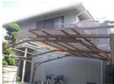
カーポートの被害
