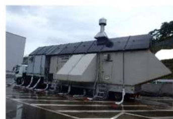
代替非常用発電機
