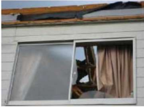
窓ガラスの損壊
