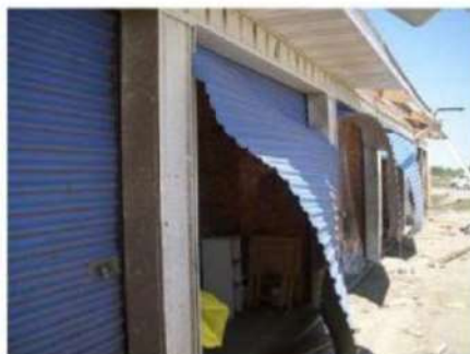
シャッターの被害
