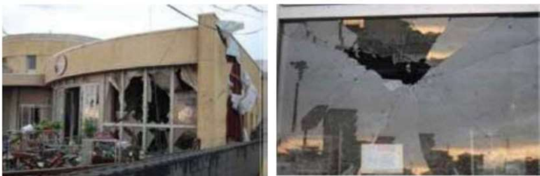
店舗の窓ガラスの被害状況
