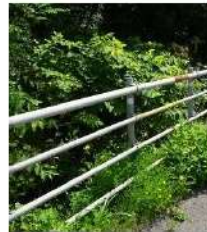
ガードパイプ
