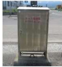
消火栓（ホース格納箱）
