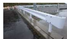
ガードレール
