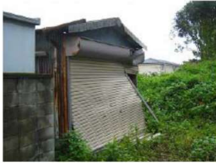
シャッターの外れ
