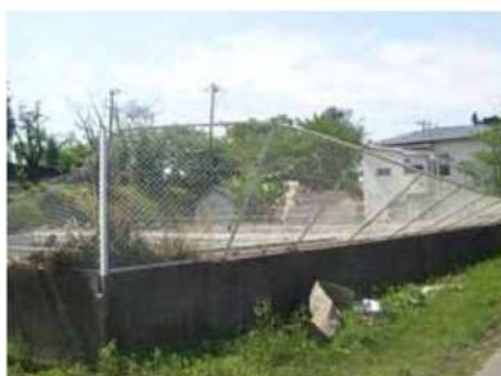
フェンスの被害状況
