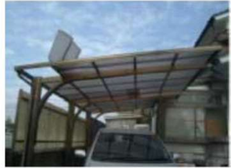
カーポート屋根の破損
