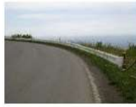
ガードレール
