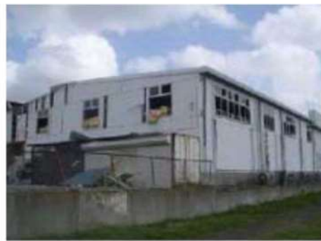
窓ガラスの破損
