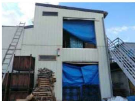
シャッターの被害
