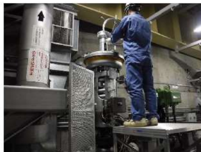
【図3 3B-主蒸気逃がし弁操作風景】
