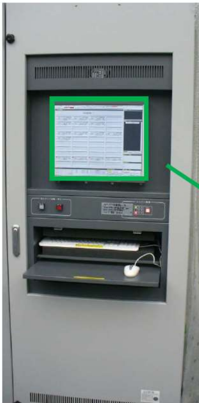
写真④ 中央制御室 総合操作盤
