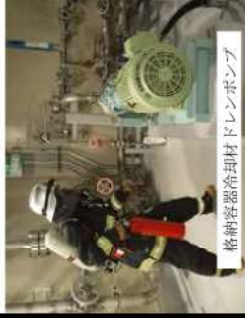
格納容器冷却材ドレンポンプ ⑤消火栓による消火
