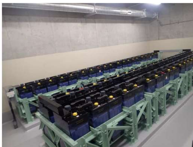
第 1-27 図：安全系蓄電池室の状況
