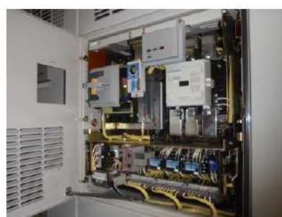
パワーコントロールセンタ
