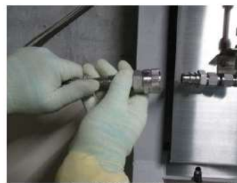
アニュラス全量排気弁操作用可搬型 窒素ガスボンベのカップラ接続 (原子炉補助建屋 T.P. 40.3m)
