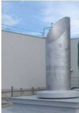
図3 主蒸気安全弁排気管の設置状況
