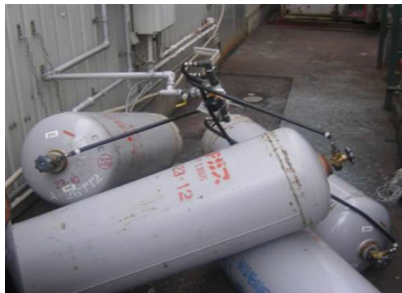
図16 東日本大震災でのLPガスボンベの被災状況※
