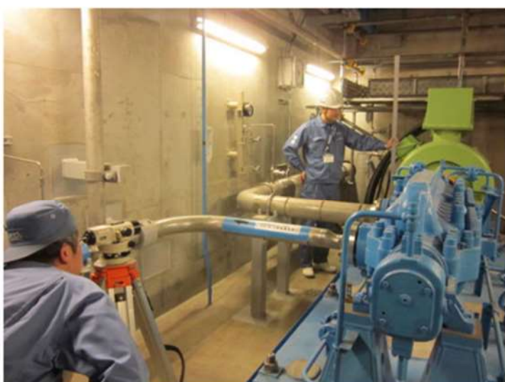
別紙 1-図 2 ポンプ類（電動補助給水ポンプ）
