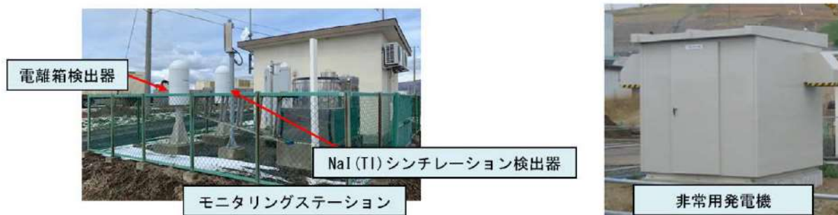
第1.1.5図 モニタリングステーションの設置状況
